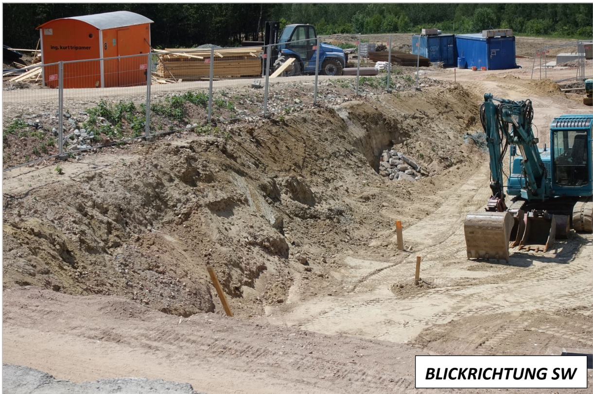
Abb. 2.2.1.6.: Baugrube für eine Lagerhalle westlich von Pinkafeld: Hanganriss an der Südseite des Baustellengeländes; schluffig, sandige Sedimente des Sarmatium (Foto: M. Peresson).
