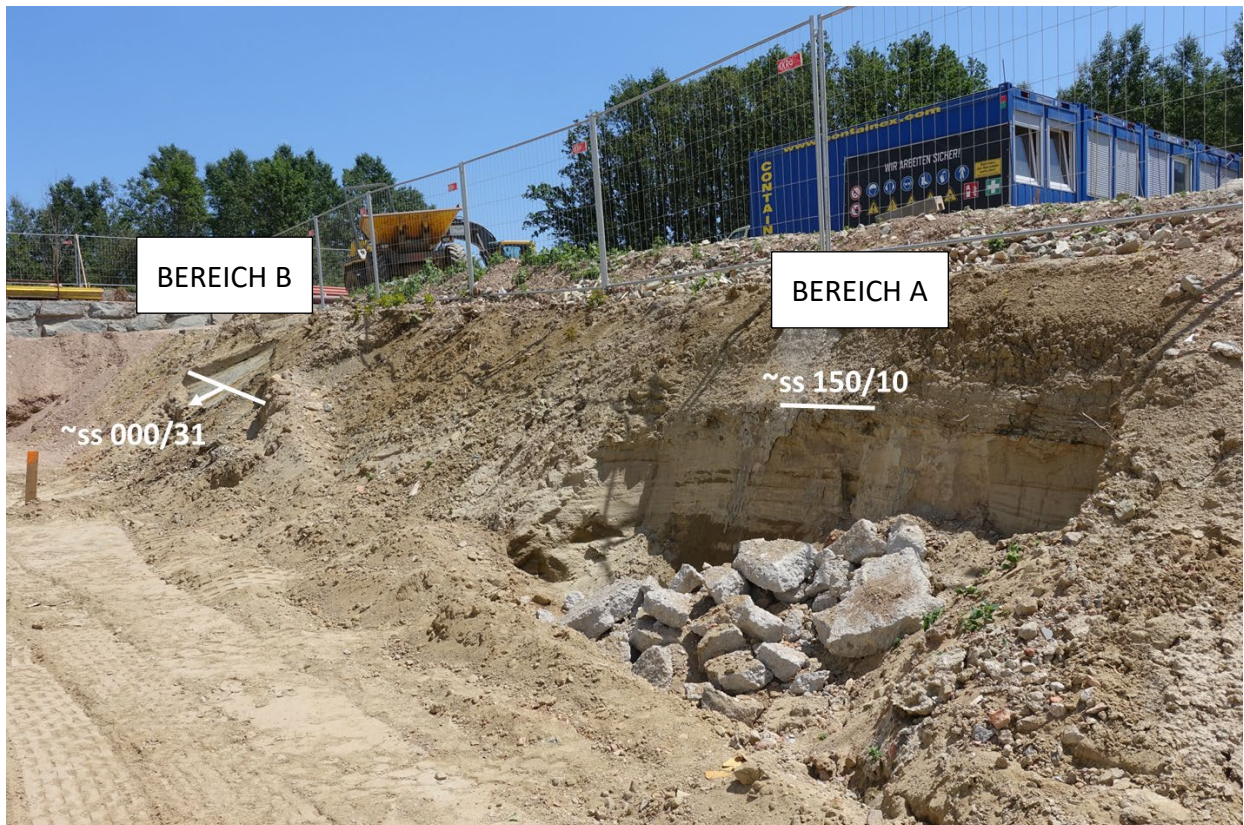
Abb. 2.2.1.19.: Baugrube für eine Lagerhalle westlich von Pinkafeld: Hanganriss an der Südseite des Baustellengeländes; Strukturgeologische Messungen im Aufschlussbereich (Foto: M. Peresson).
