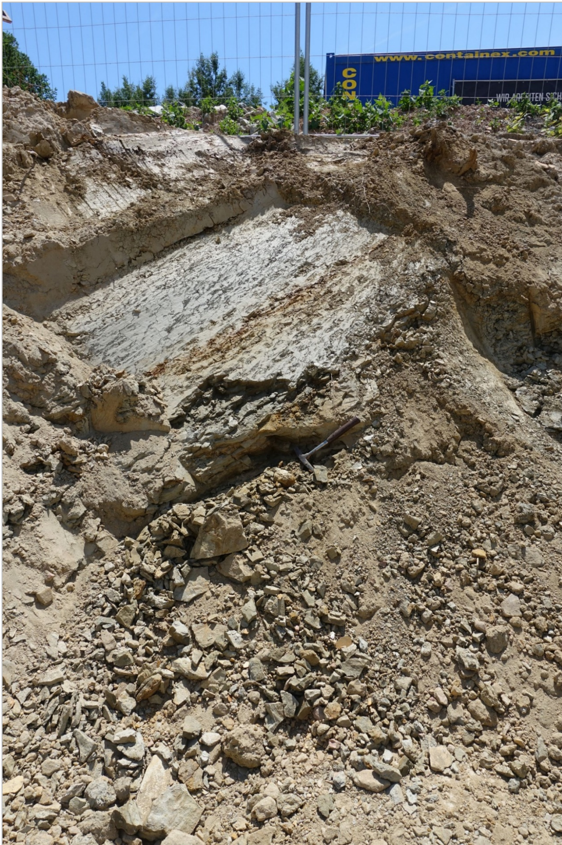
Abb. 2.2.1.15.: Baugrube für eine Lagerhalle westlich von Pinkafeld: Hanganriss an der Südseite des Baustellengeländes; Hangendster Abschnitt im Profil mit tonigem Schluff; gekippt; mögliche Störungszone (Foto: M. Peresson).
