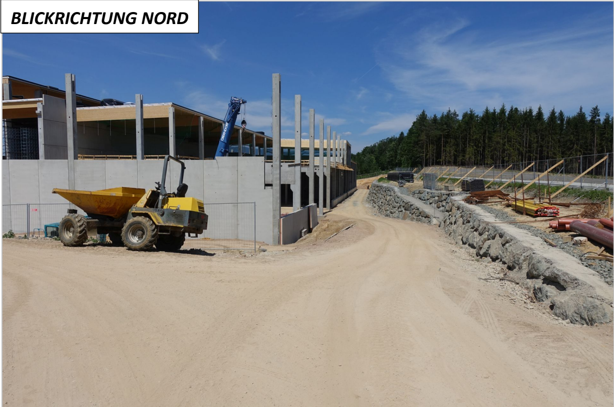
Abb. 2.2.1.7.: Baugrube für eine Lagerhalle westlich von Pinkafeld: Hanganriss an der Ostseite des Baustellengeländes bereits mit Steinmauer gesichert (Foto: M. Peresson).
