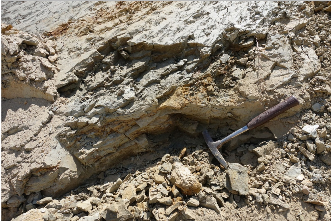
Abb. 2.2.1.16.: Baugrube für eine Lagerhalle westlich von Pinkafeld: Hanganriss an der Südseite des Baustellengeländes; Hangender toniger Schluff; gekippt; mögliche Störungszone mit N-S streichenden Klüften (Foto: M. Peresson).
