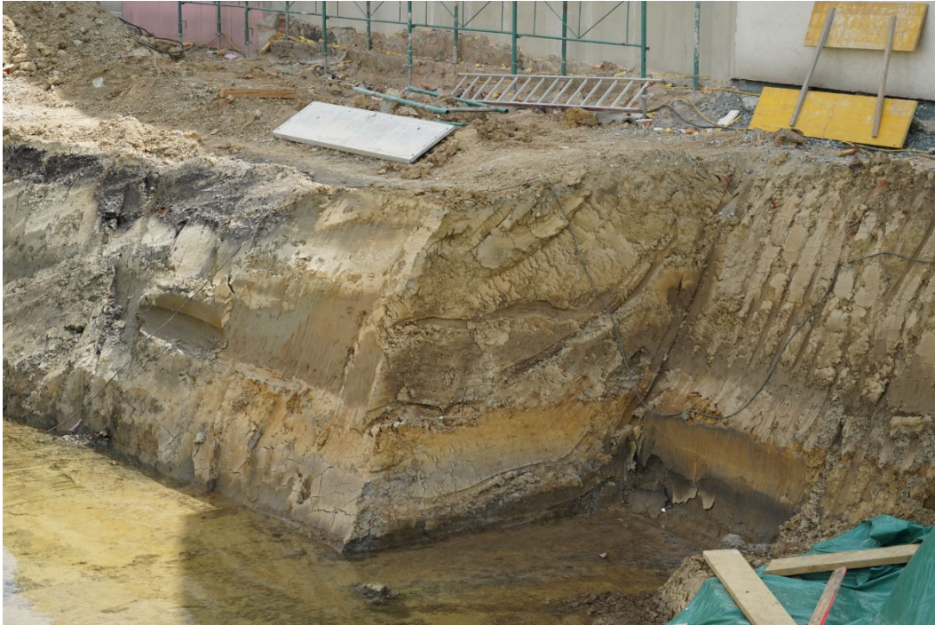
Abb. 2.3.1.15.: Baustelle für ein Tageszentrum in Kohfidisch: Abfolge aus Schluffen und Tonen in wechselnden Farbnuancen – Überflutungssedimente; (Foto: M. Peresson).
