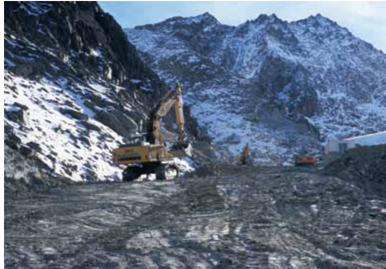
Der "Notweg" führt durch ein äußerst steiles Gelände, sodass laufend Lawinen, Eis- und Steinschlag drohen.
