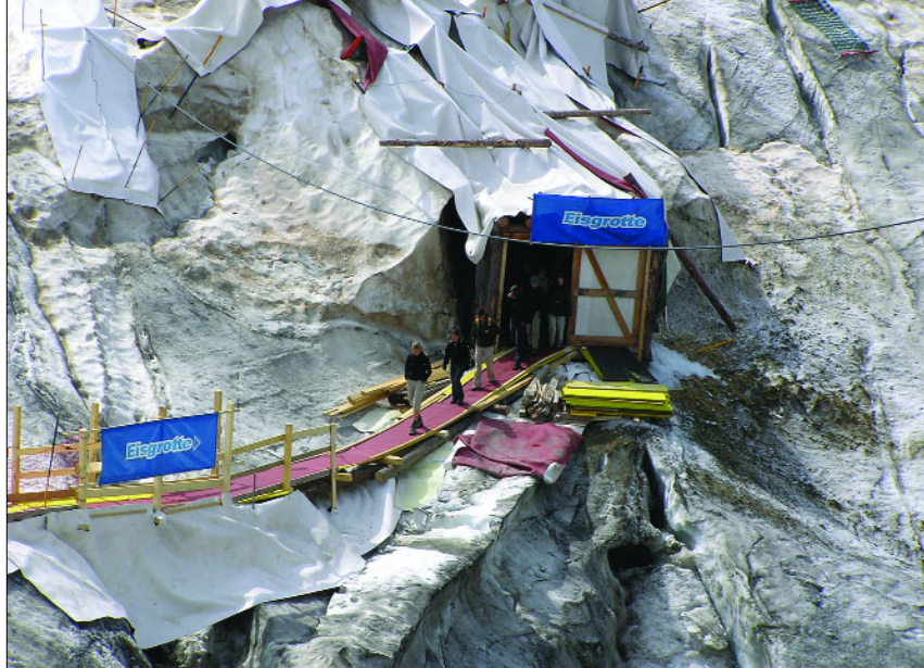
Eisgrotte im Murtel-Corvatsch Eisgrat nahe der Bergstation der Corvatschbahn (3.300 m). Die Folienbahnen dienen dazu, die Eisschmelze zu reduzieren und damit ein Durchschmelzen der Grottendecke im extrem warmen Sommer 2003 zu verhindern.
