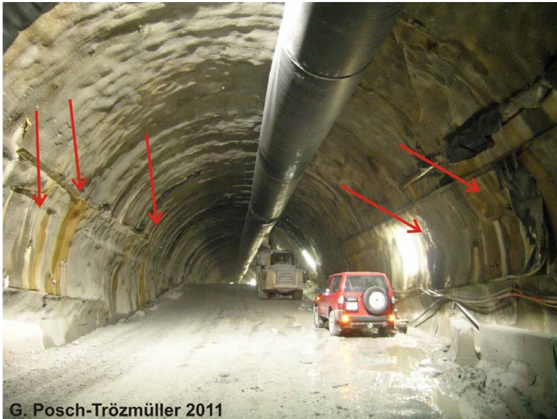
Abb. 2.1.19.: Wasseraustritte (rote Pfeile) im Bereich des Wettersteinkalks in der Tunnelröhre des Nordvortriebs.
