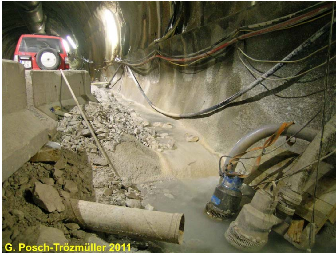
Abb. 2.1.21.: Am Übergang vom Haselgebirge (hinter dem Betrachter) zum Wettersteinkalk wird das Wasser, das von den Firnen und Ulmen in die Tunnelröhre eintritt, abgepumpt.
