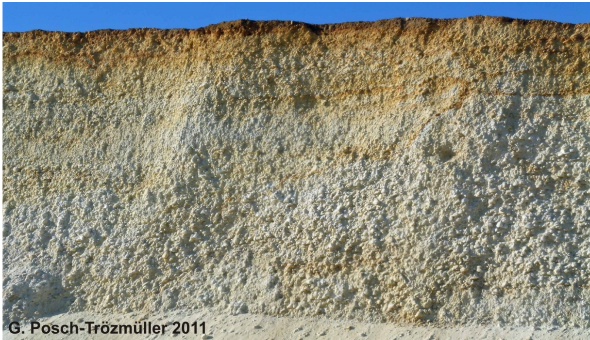
Abb. 2.2.36.: Blick auf einen Abschnitt einer Kieswand. Deutlich sichtbar ist in den hangenden Bereichen die rostrote Verfärbung, die ins Liegende abnimmt.
