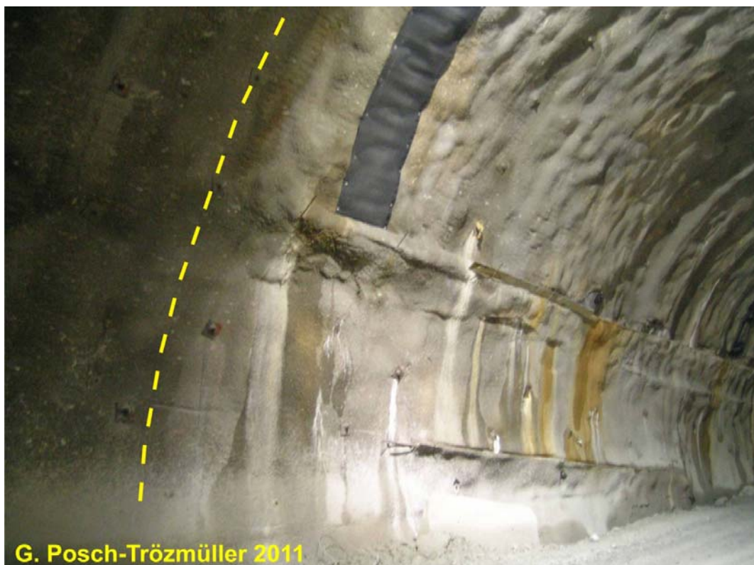
Abb. 2.1.18.: Die gelbe Linie markiert symbolisch die Grenze zwischen Haselgebirge (links) und Wettersteinkalk (rechts): Im Bereich des Haselgebirges ist die Spritzbetonschale der Tunnelröhre trocken, während im Bereich des Wettersteinkalks zahlreiche Wasseraustritte zu sehen sind.
