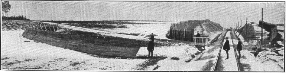
Abb. 63. Bogenförmig angeordneter amerikanischer Bockzaun zur Sicherung eines Einschnittsendes
