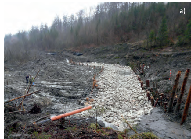
Abb. 11. Das Auffüllen der Drainagegräben erfolgte mit Kalkgrobschlag (a). Die Drainagegräben wurden so angelegt, dass sie gleichzeitig als Baustellenstraßen dienen (b; WEIDINGER, 2009: Abb. 12). Beide Fotos: Wolfgang Gasperl.
