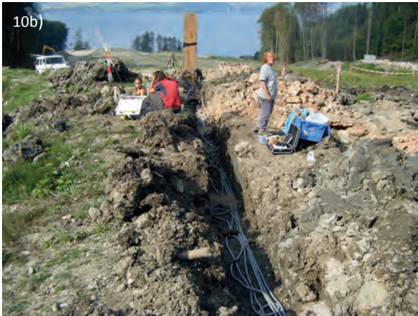
Abb. 10. Installation des Ketteninklinometers mittels Helikopter (a). Anlage der fixen Geoelektrik-Messstrecke (b). Beide Fotos: Wolfgang Gasperl.
