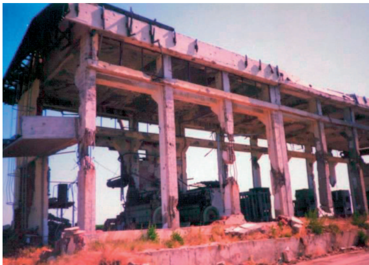
Slika 6. Uništena crpna stanica Paulin dvor
