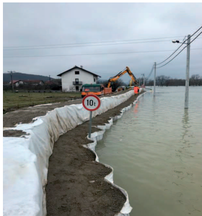
Slika 3. Postavljeni sustav box barijera u Karlovcu zadržava prodor 80-ak centimetara poplavnih voda rijeke Korane (ožujak 2018. godine)
