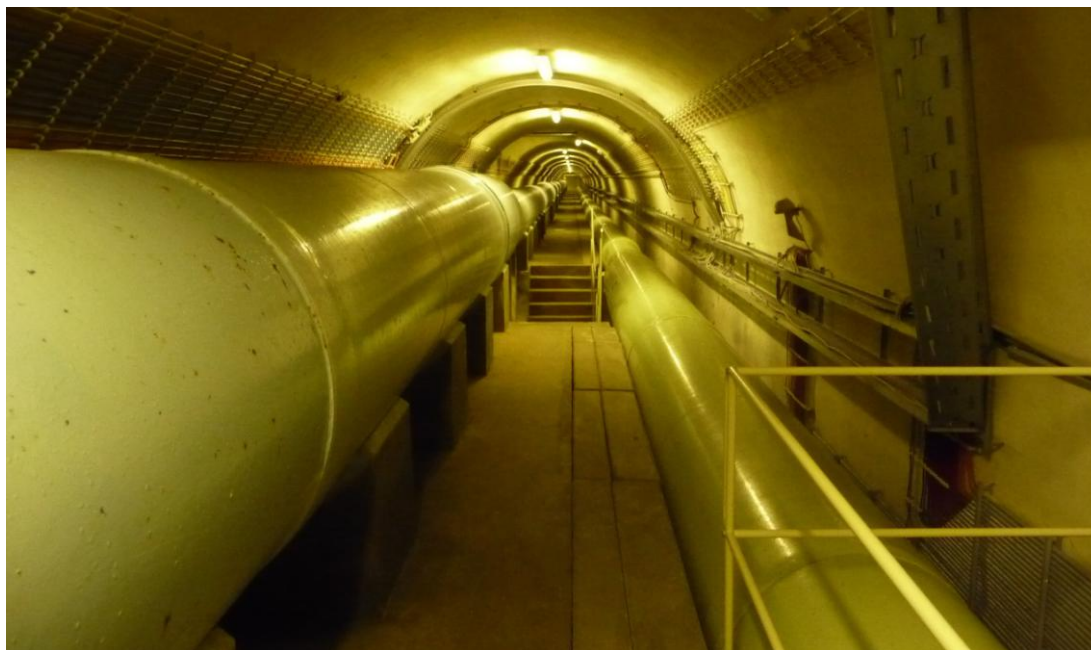
Druckrohrleitung der Wiener Hochquellenleitung, © H. Loishandl-Weisz.
